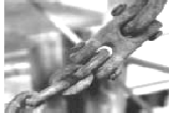
Otro eslabón de doble grillete inaceptable
