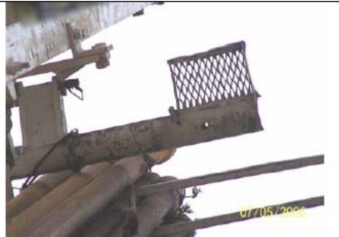
Zona de la plataforma de la torre desde donde cayó la barra deslizable
